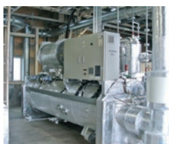
ターボ冷凍機
