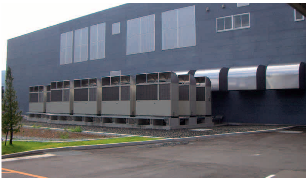
LNG使用のGHP（ガスヒートポンプ）装置（中部商品センター）
