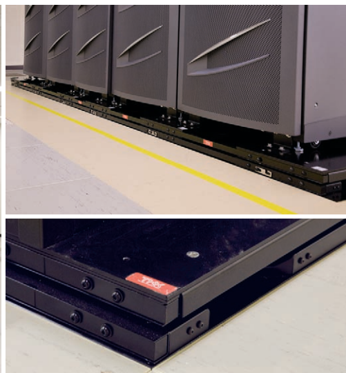
JAL免震サーバー
