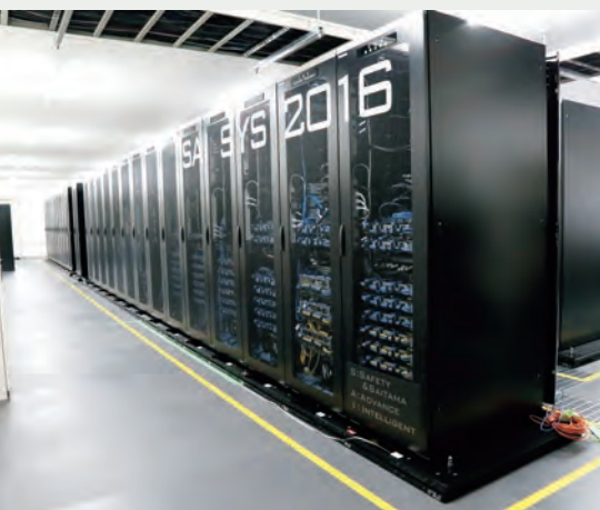
サーバーを守る免震装置
