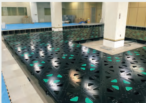
自由設計可能な THK の免震装置を貼ったサーバールーム
