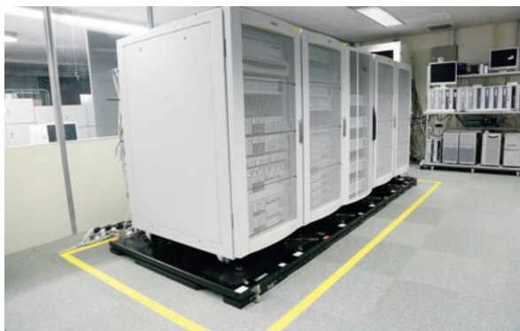
熊本地震の揺れでも問題なく機能を発揮したサーバー免震装置
