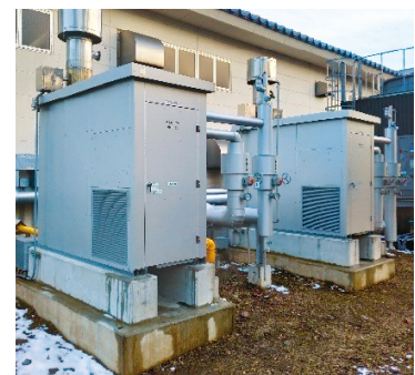
温水ボイラー
