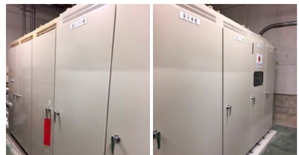
新型トランスを設置した電気室
