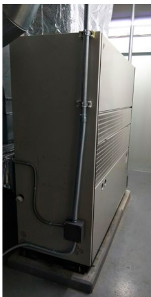
精密測定室の更新した空調設備
